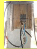
Parte viva exposta da instalação elétrica
