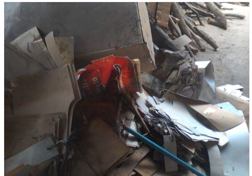
Foto 02: Disposição inadequada de resíduos sólidos
