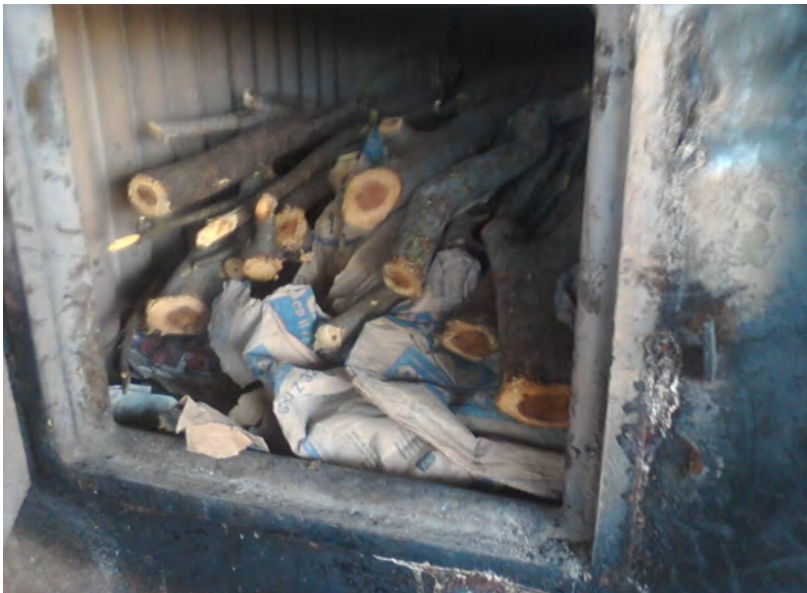
Foto 01: Incineração inadequada de resíduos sólidos
