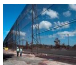
Barreira de Proteção de Vento Estações - Porto de Itaboraí (ES) - VALE
