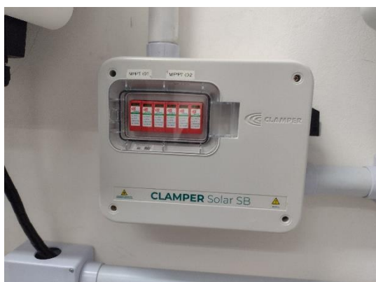
Figura 3 - Identificação das stringbox seguindo o projeto do inversor 1.
