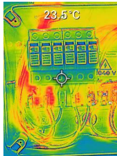
Figura 34 – Imagem com a câmera térmica da stringbox do inversor 2.
