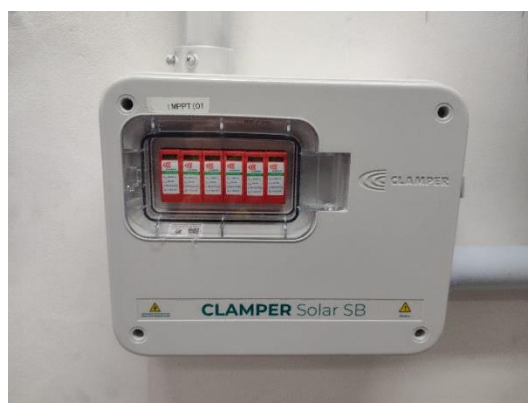
Figura 4 - Identificação das stringbox seguindo o projeto do inversor 2.
