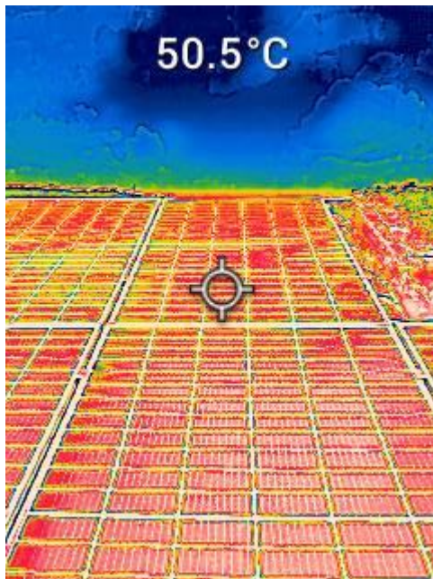
Figura 18 - Imagem térmica módulo 13.
