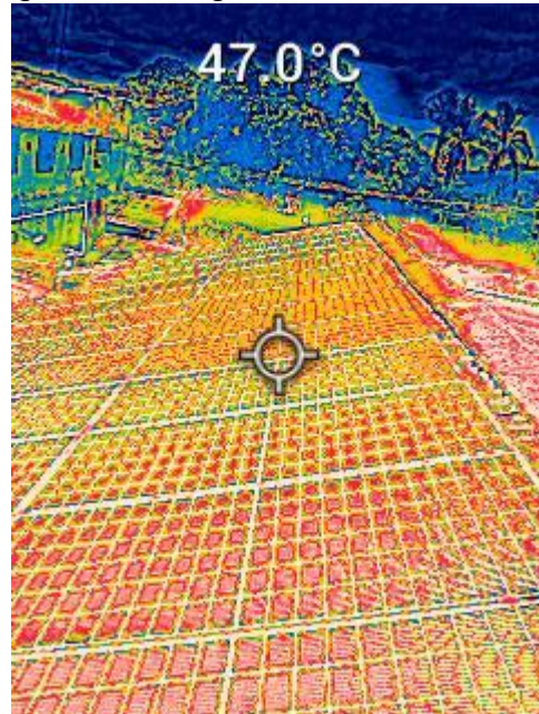
Figura 9 - Imagem térmica módulo 4.
