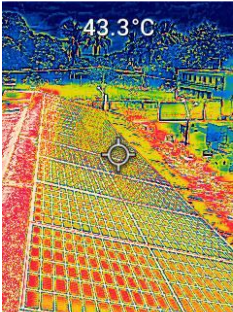
Figura 6 - Imagem térmica módulo 1.
