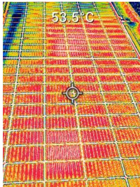
Figura 15 - Imagem térmica módulo 10.
