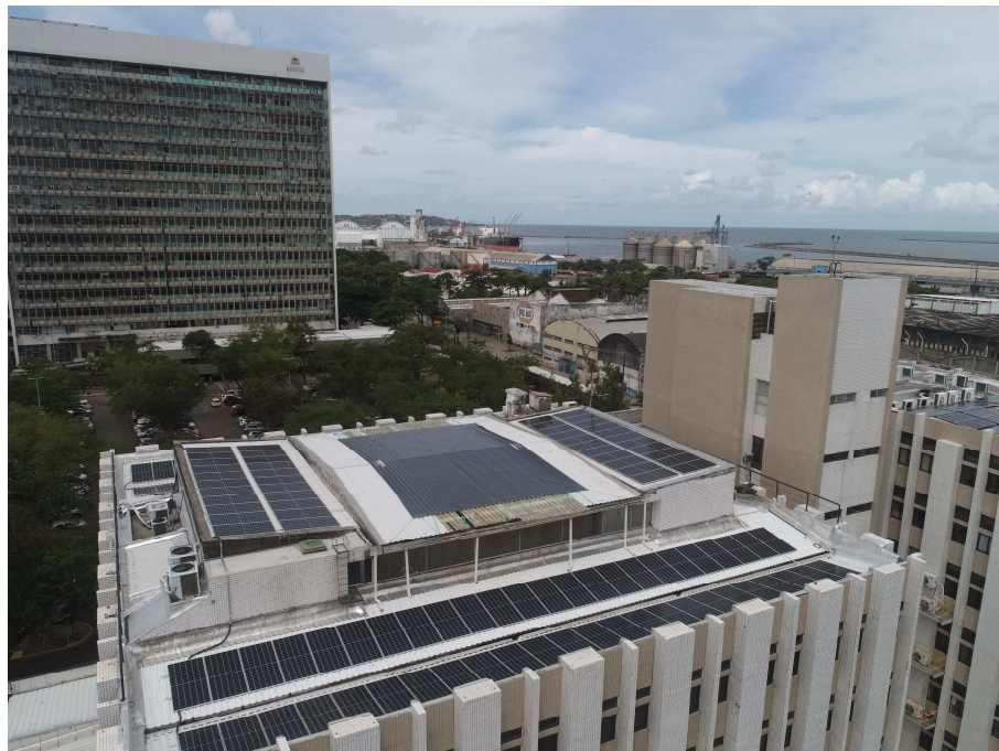
Imagem 7 – Placas solares no edifício sede (Recife/PE).
