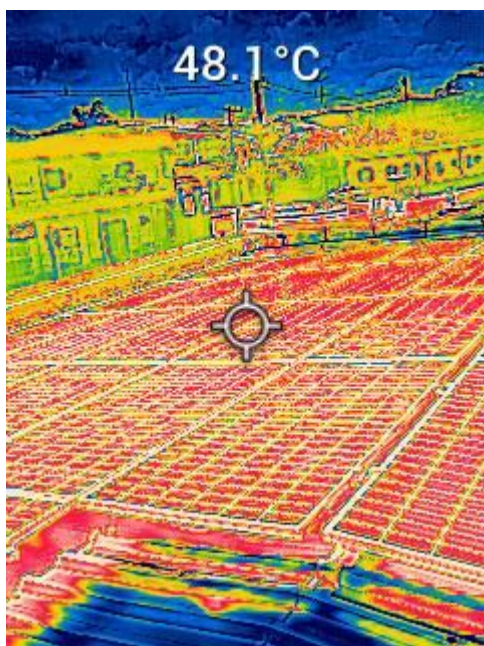
Figura 22 - Imagem térmica módulo 17.
