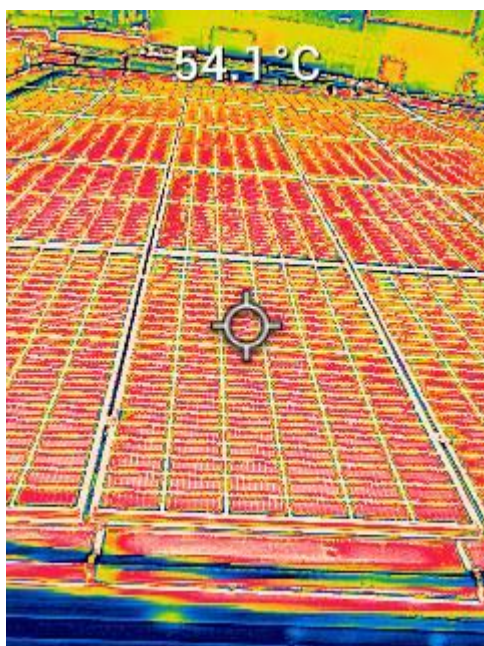
Figura 10 - Imagem térmica módulo 5.
