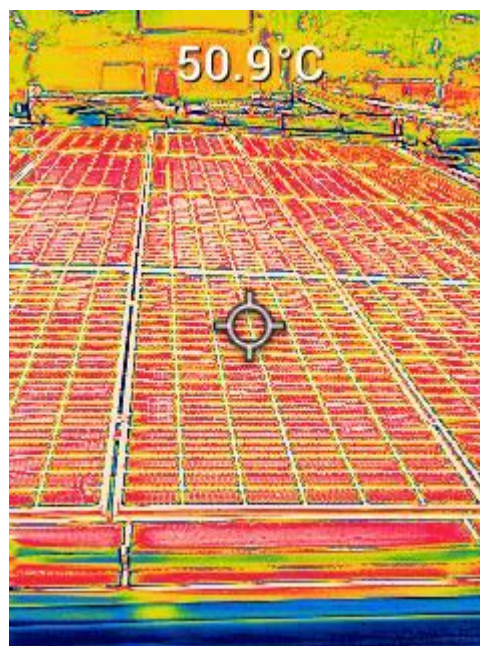
Figura 15 - Imagem térmica módulo 10.
