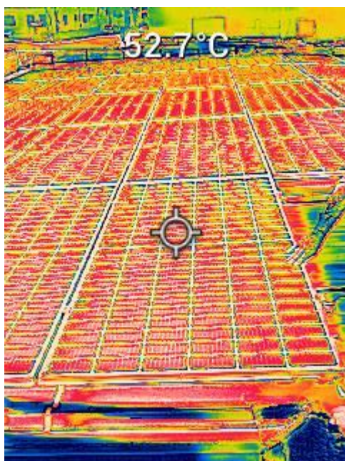
Figura 6 - Imagem térmica módulo 1.
