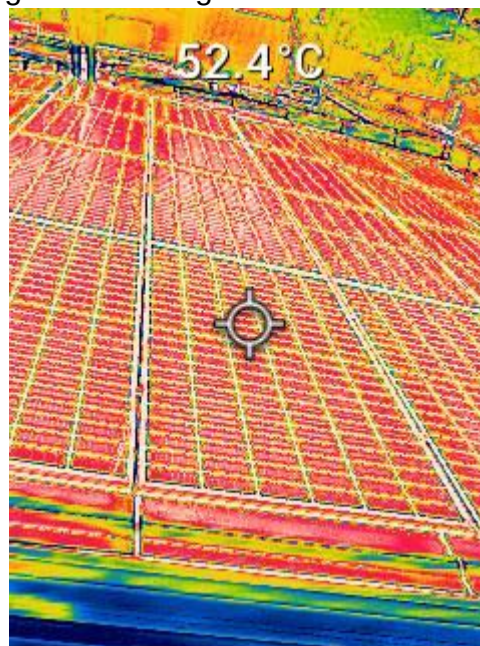
Figura 13 - Imagem térmica módulo 8.
