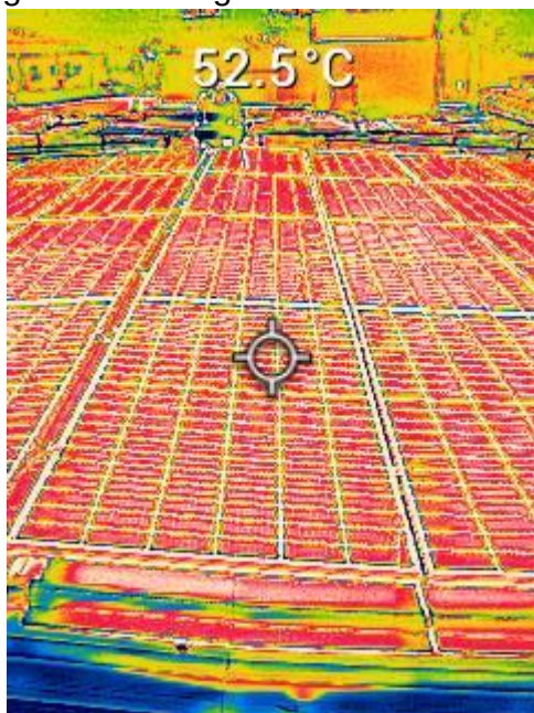
Figura 12 - Imagem térmica módulo 7.
