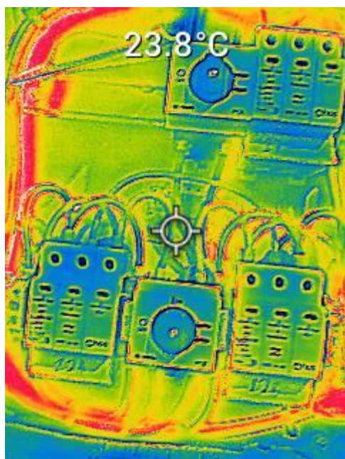
Figura 37 – Imagem com a câmera térmica da stringbox do inversor 1.
