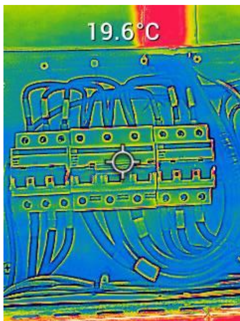
Figura 28 – Imagem com a câmera térmica do quadro principal da conexão CA.
