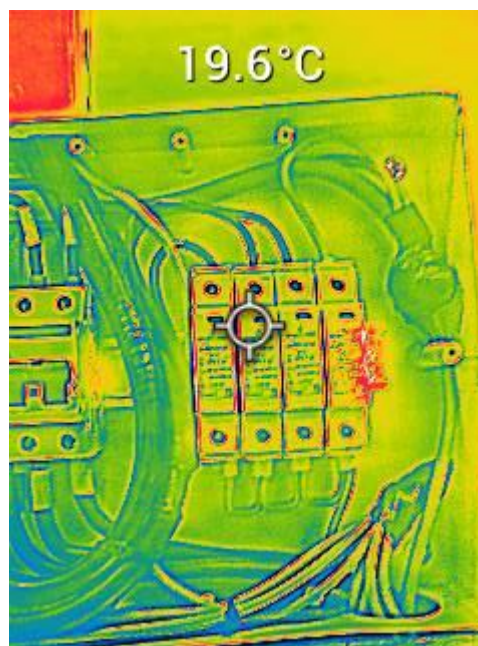
Figura 29 – Imagem com a câmera térmica do quadro principal com os DPS.
