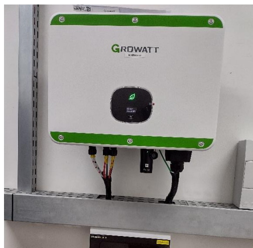
Figura 2 - Foto do inversor 2 e da identificação dele.
