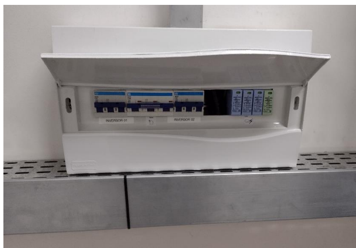
Figura 5 – Quadro geral dos disjuntores.
