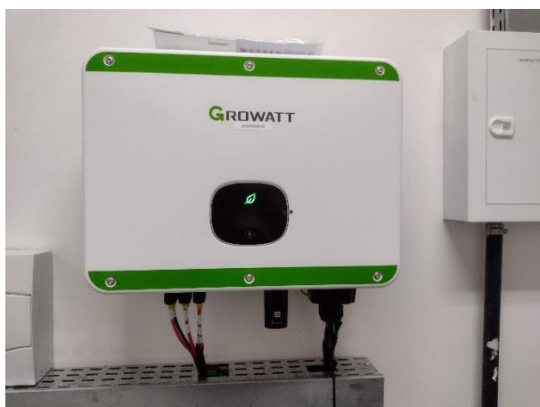
Figura 1 – Foto do inversor 1 e da identificação dele.
