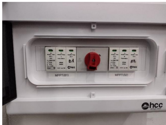
Figura 2 - Imagem stringbox com identificação.
