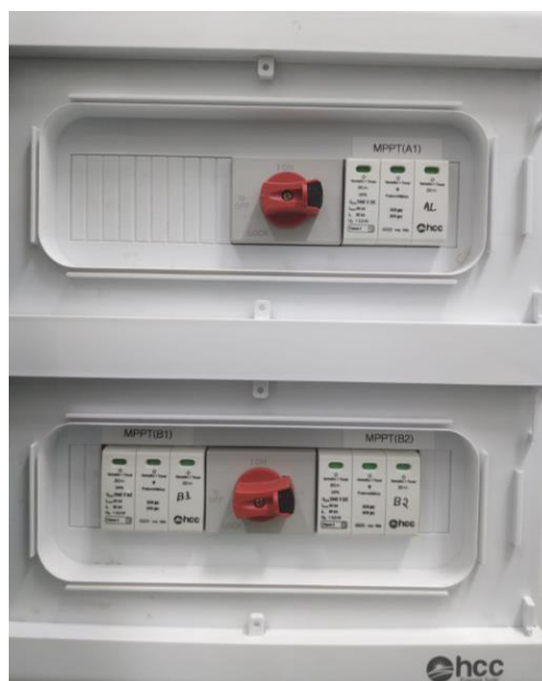
Figura 9 - Identificação das stringbox seguindo o projeto do inversor 2.
