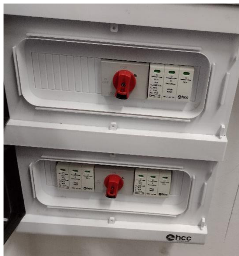
Figura 4 - Imagem stringbox sem identificação do inversor 2.
