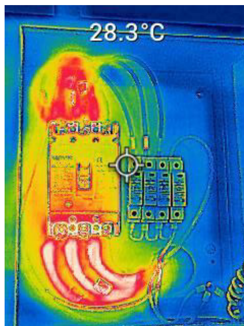
Figura 24 – Imagem com a câmera térmica do quadro secundário da conexão CA.
