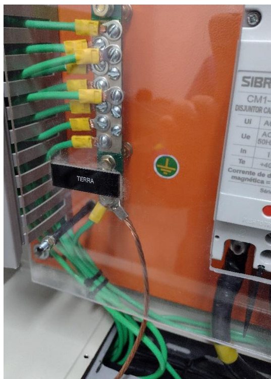
Figura 5 – Imagem do aterramento com cabo 6mm 2 .
