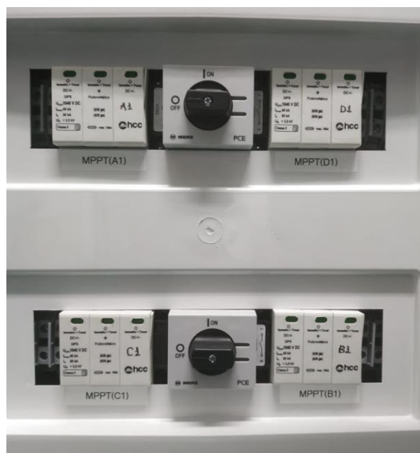
Figura 8 - Identificação das stringbox seguindo o projeto do inversor 1.
