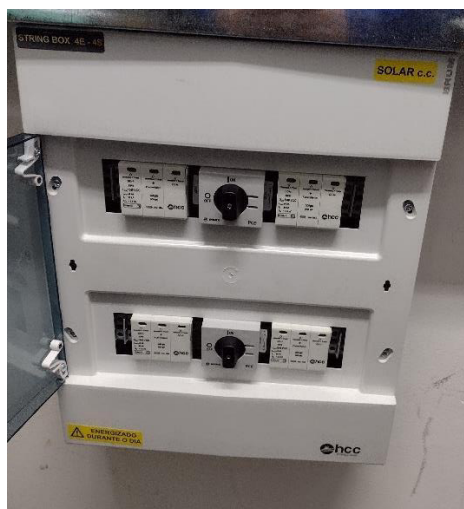
Figura 2 - Imagem stringbox sem identificação do inversor 1.
