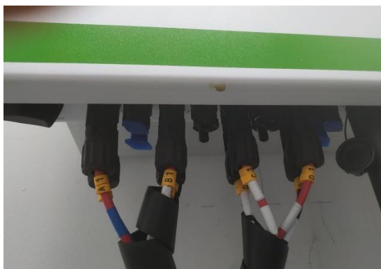
Figura 6 - Cabeamento identificado na entrada CC do inversor 1.
