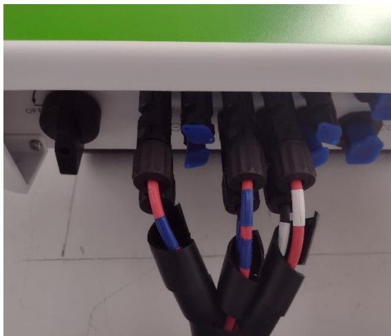
Figura 3 - Imagem do cabeamento da entrada CC do inversor 2.
