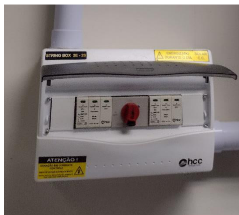
Figura 2- Imagem stringbox sem identificação.
