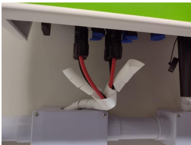
Figura 1- Imagem do cabeamento da entrada CC dos inversores.
