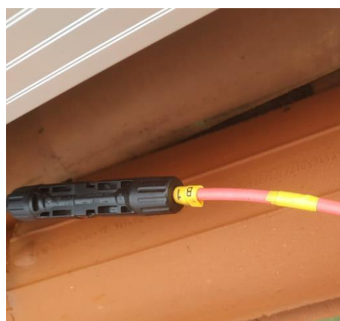
Figura 5- Cabeamento identificado no telhado.
