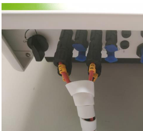
Figura 4- Cabeamento identificado na entrada CC dos inversores.
