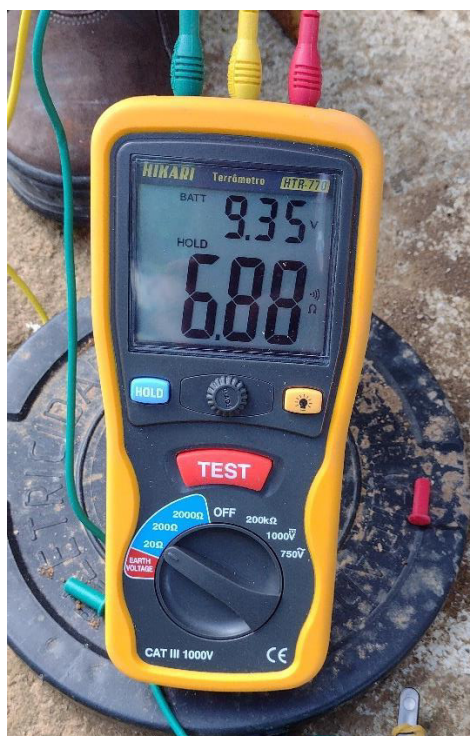
Figura 19 – Medição com o terrômetro da resistência de aterramento.
