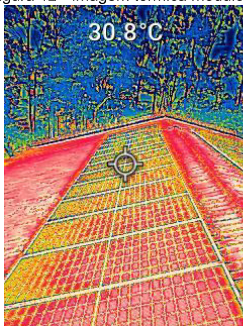
Figura 14 - Imagem térmica módulo 6.
