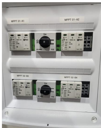
Figura 2- Imagem stringbox 1 com identificação.
