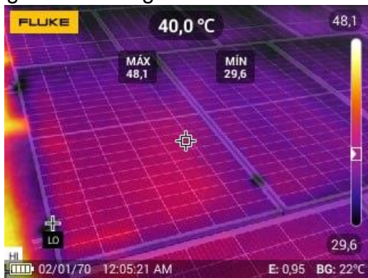
Figura 32 - Imagem térmica módulo 29.
