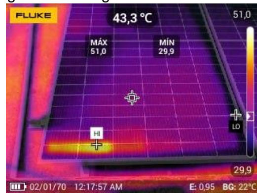
Figura 17 - Imagem térmica módulo 14.
