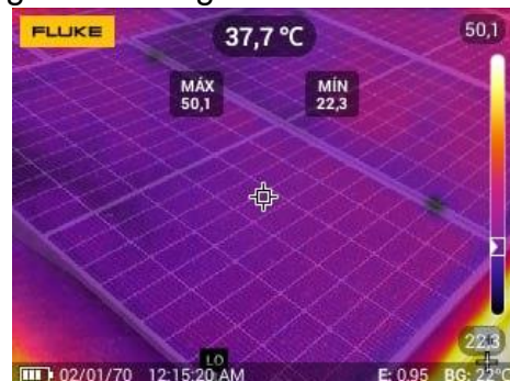
Figura 11 - Imagem térmica módulo 8.
