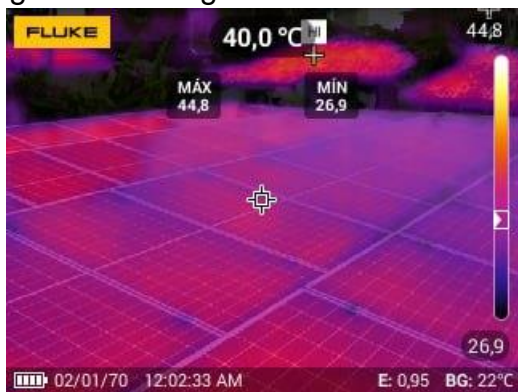
Figura 30 - Imagem térmica módulo 27.
