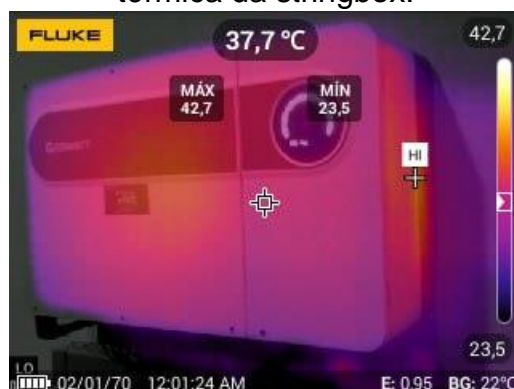
Figura 46 – Imagem com a câmera térmica do inversor.
