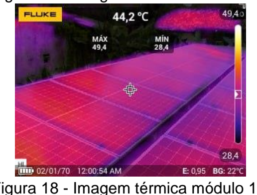
Figura 18 - Imagem térmica módulo 15.
