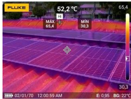
Figura 5 - Imagem térmica módulo 2.
