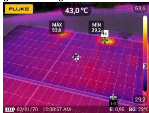
Figura 41 - Imagem térmica módulo 38.
