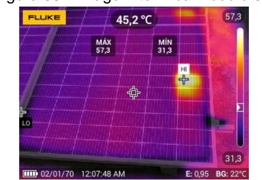
Figura 35 - Imagem térmica módulo 32.
