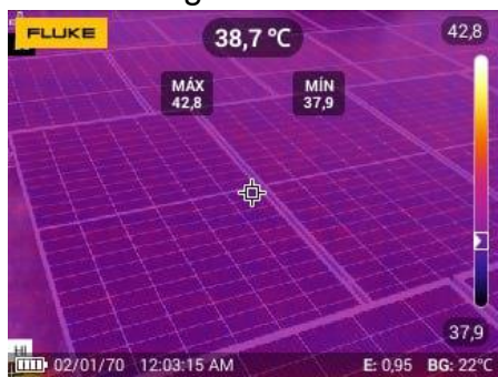
Figura 26 - Imagem térmica módulo 23.
