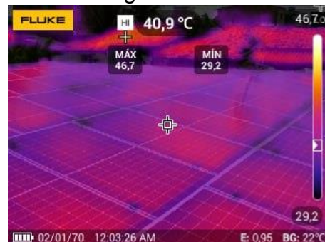
Figura 27 - Imagem térmica módulo 24.
