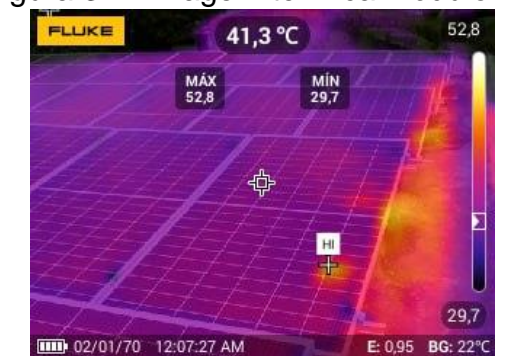
Figura 34 - Imagem térmica módulo 31.
