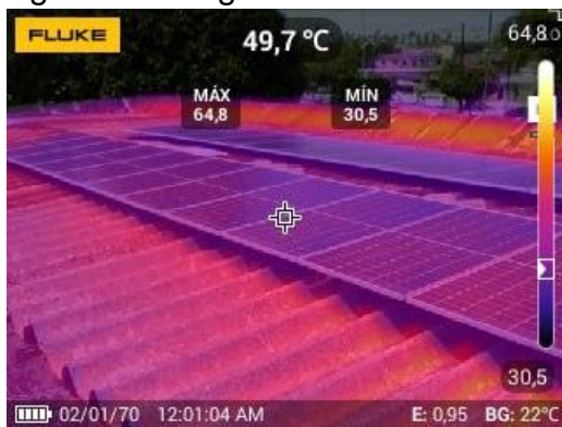
Figura 6 - Imagem térmica módulo 3.
