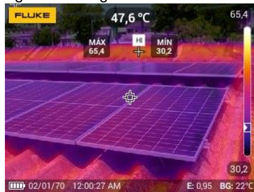
Figura 9 - Imagem térmica módulo 6.
