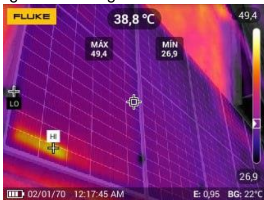
Figura 14 - Imagem térmica módulo 11.
