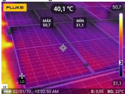
Figura 24 - Imagem térmica módulo 21.
