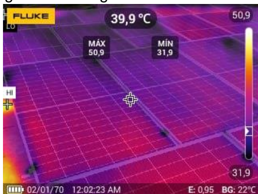
Figura 22 - Imagem térmica módulo 19.
