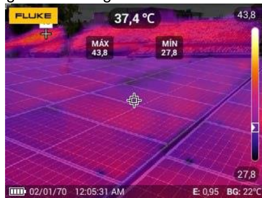
Figura 33 - Imagem térmica módulo 30.
