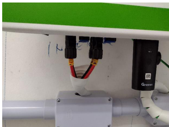
Figura 1 - Imagem do cabeamento da entrada CC do inversor.
