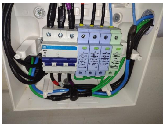
Figura 4 - Imagem dos disjuntores e disjuntor geral.
