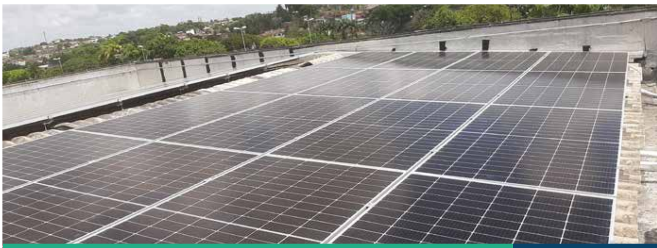
Células de captação de energia solar no Fórum de Olinda
