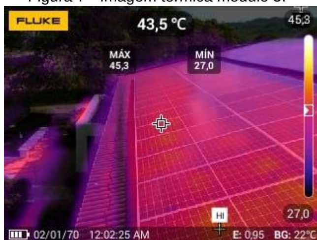
Figura 9 - Imagem térmica módulo 7.
