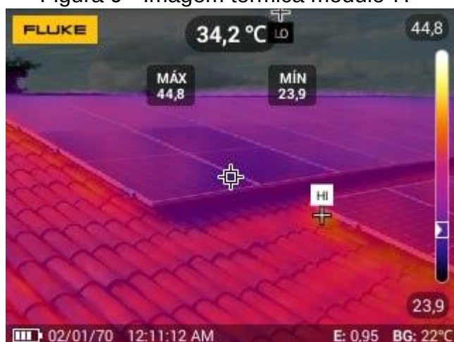
Figura 11 - Imagem térmica módulo 9.
