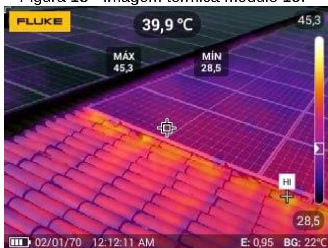
Figura 17 - Imagem térmica módulo 15.
