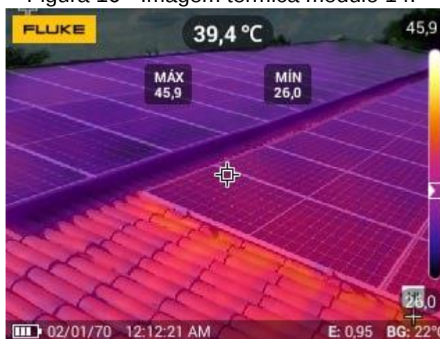
Figura 18 - Imagem térmica módulo 16.
