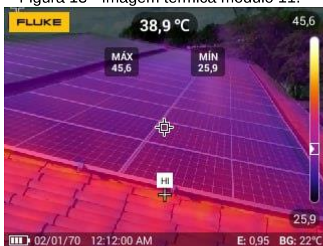
Figura 15 - Imagem térmica módulo 13.
