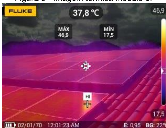
Figura 10 - Imagem térmica módulo 8.
