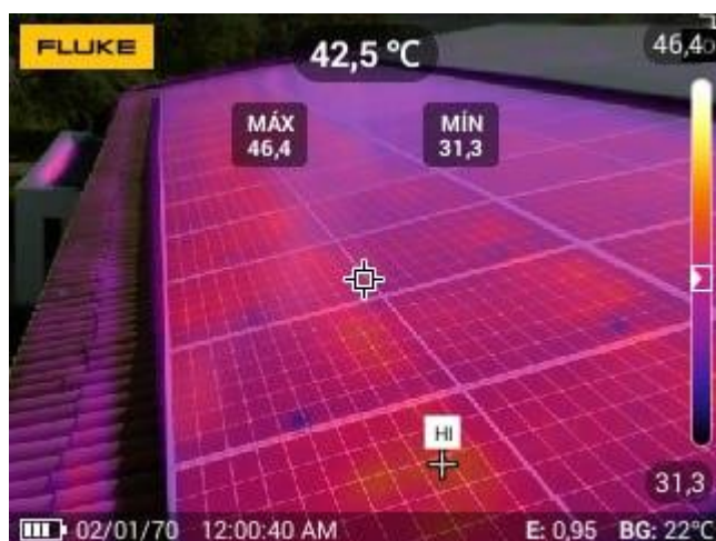
Figura 3 - Imagem térmica módulo 1.
