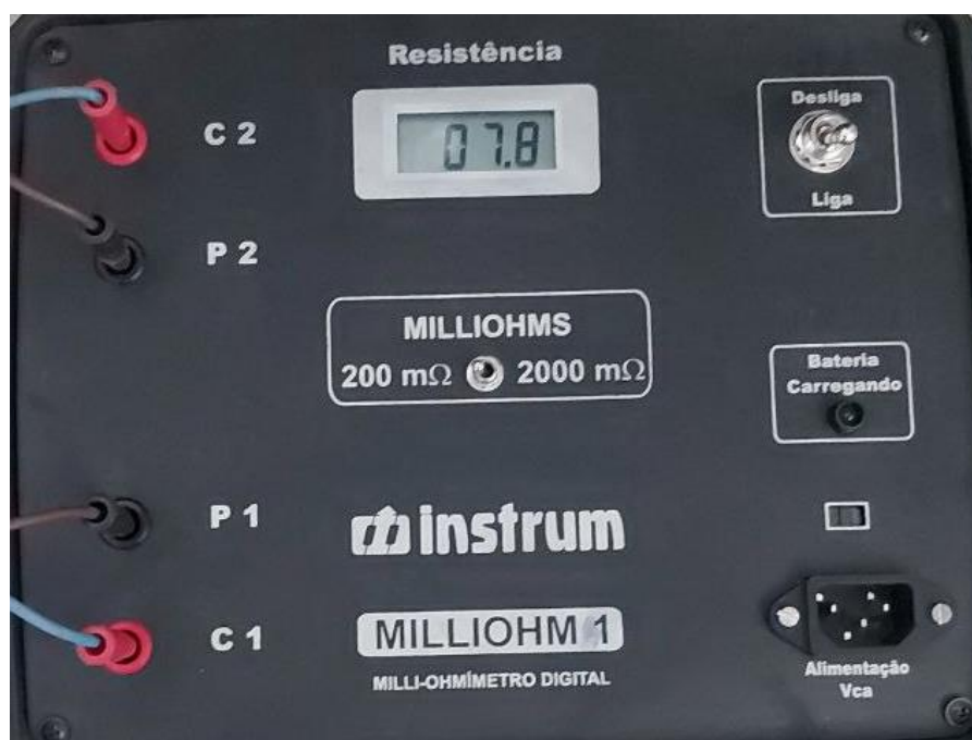
Figura 21 – Medição com o terrômetro da resistência de aterramento.
