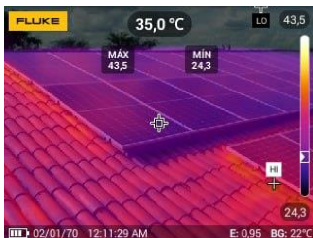
Figura 13 - Imagem térmica módulo 11.
