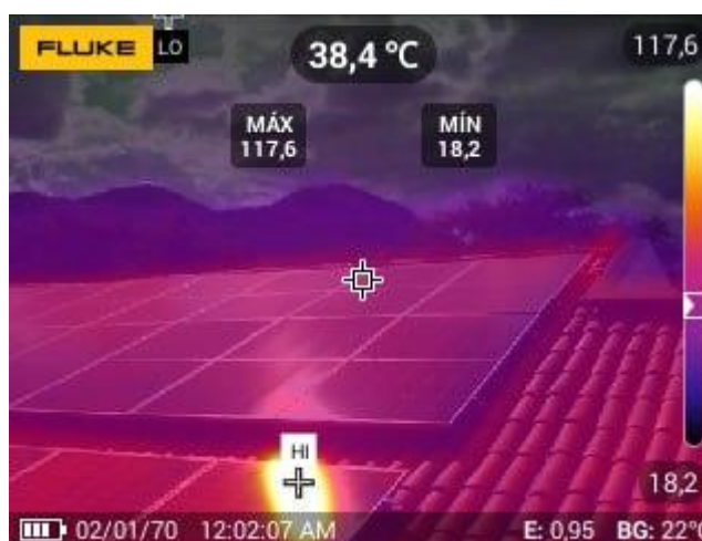
Figura 8 - Imagem térmica módulo 6.
