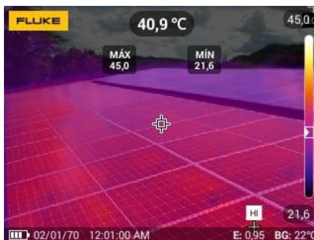
Figura 4 - Imagem térmica módulo 2.
