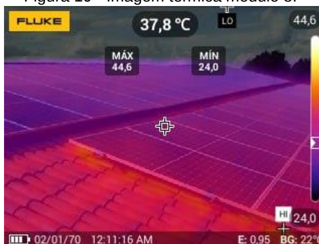
Figura 12 - Imagem térmica módulo 10.
