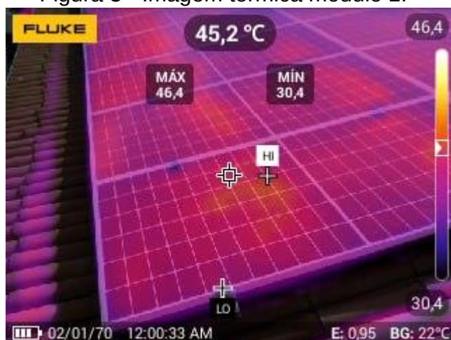
Figura 5 - Imagem térmica módulo 3.
